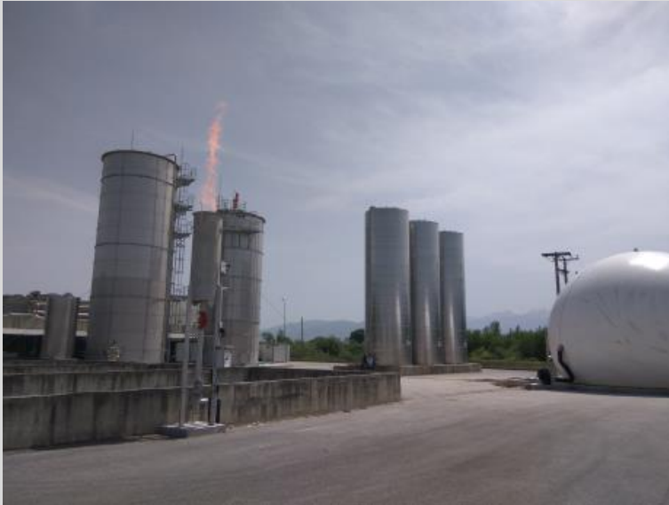
Αναερόβιος χωνευτής κατασκευασμένος από τη SIRMET S.A. (Ελλάδα)
